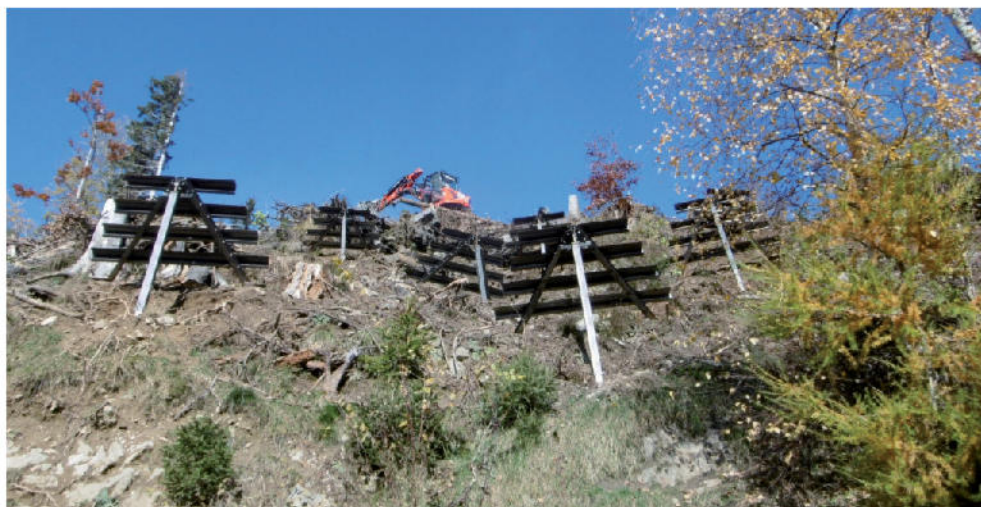
Gleitschneeschutz aus Stahl – Guggenberg/Lesachtal (Foto: WLV)
