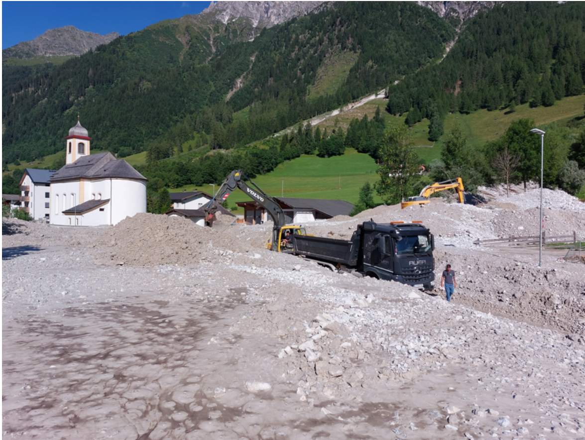
Abbildung 54: Geschiebeablagerungen des Gänsebachs im Talboden, der Gschnitzbach wurde um 100 m abgedrängt
