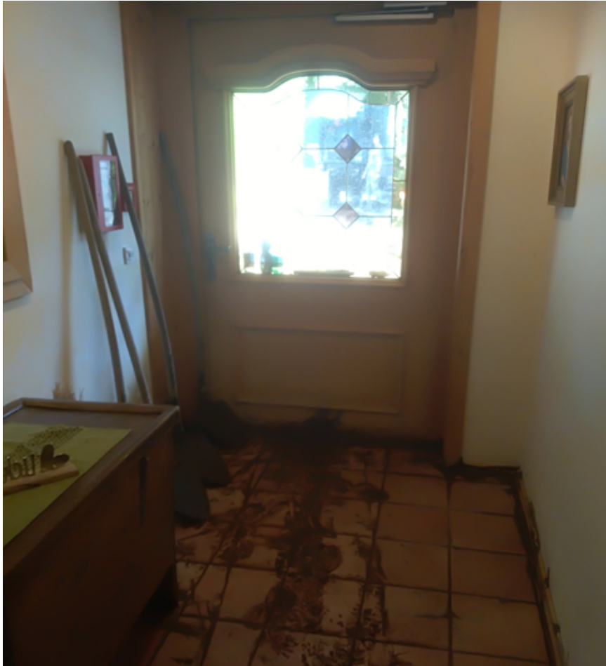
Abbildung 31: Alfeierbach, Schäden Hotel Alfeier Bergheimat, 1.7.2025
