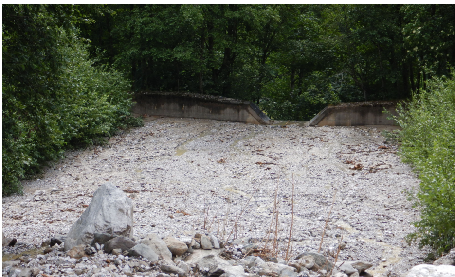
Abbildung 55: Gurnsbach, verfülltes Geschieberetentionsbecken
